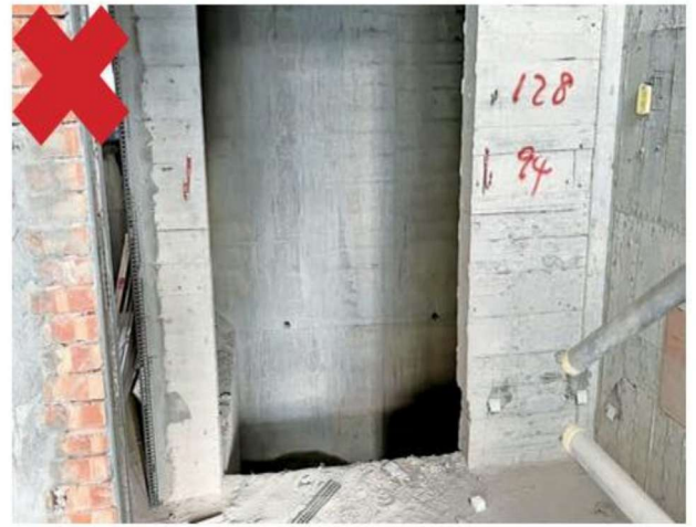
圖 16 電梯坑井開口未設護欄
