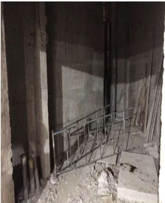
營造工地提供不符規定的合梯，導致勞工墜落左手骨折。圖 / 高雄市勞工局提供
