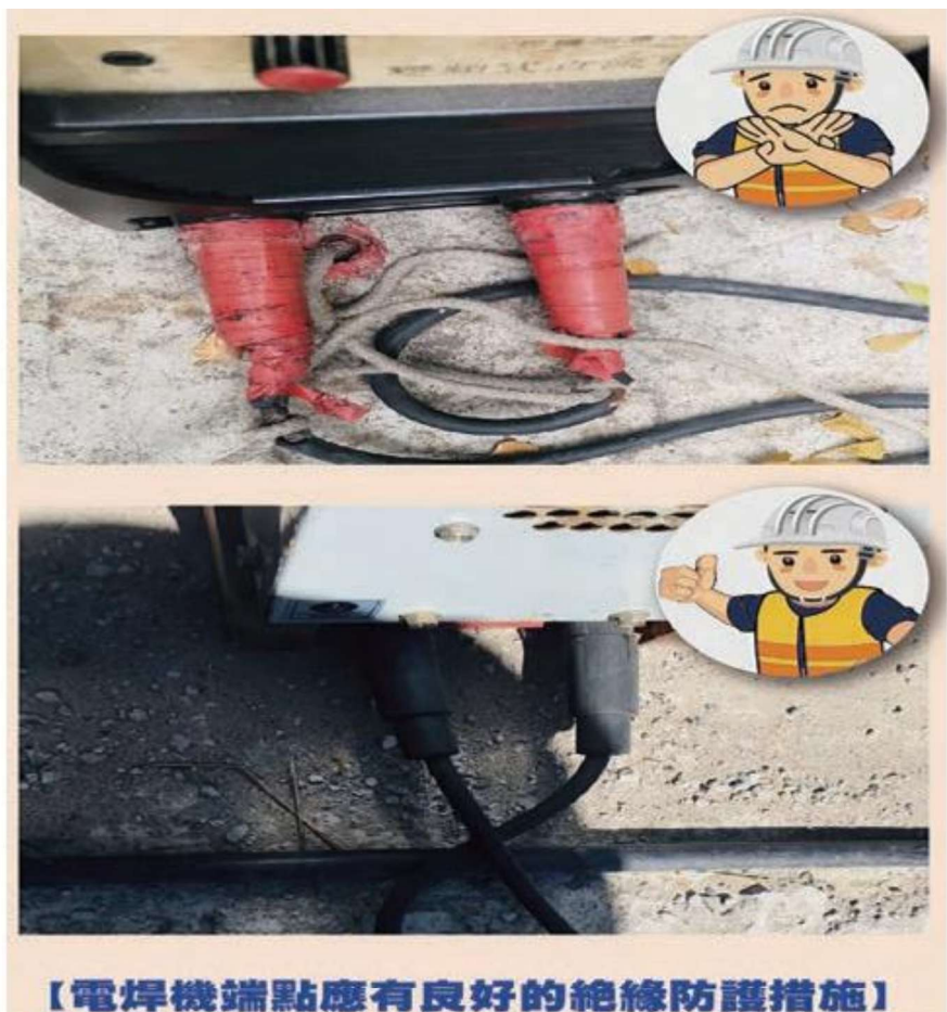
圖 24 電焊機端點應有良好的絕緣防護
