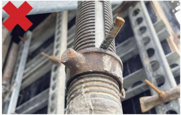
圖 33 可調鋼管支撐以鋼筋取代制式插銷固定高度 (錯誤例)
