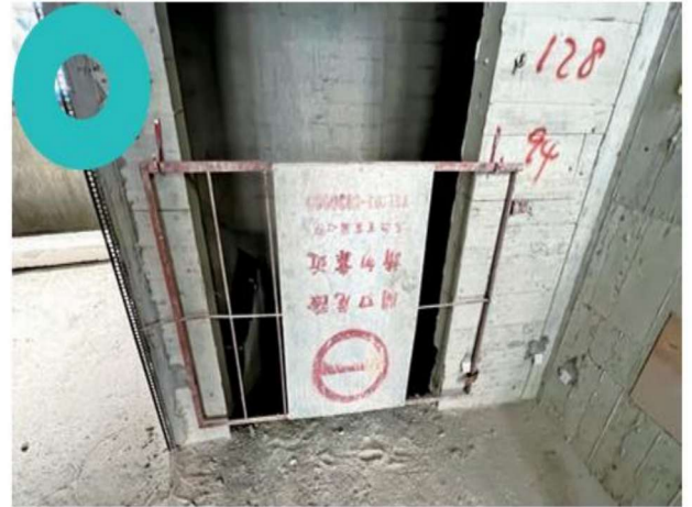
圖 17 電梯坑井開口已設活動式護欄 (警告標示用語誤反置)
