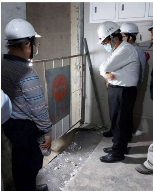
高市苓雅區一工地傳工安事故，一名工人墜電梯井傷重死亡，工務局到場了解，工務局提供
