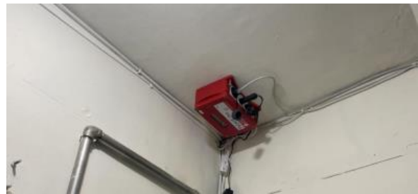
d. 頂樓強震儀配置照片
