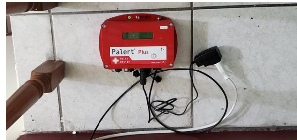
d. 頂樓強震儀配置照片
