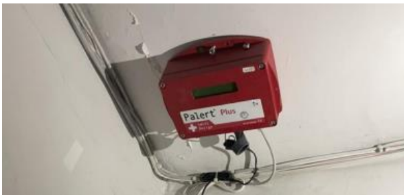
c. 2樓強震儀配置照片
