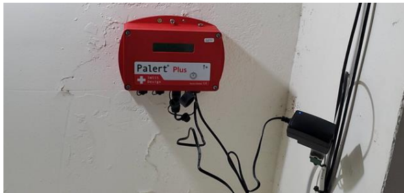
c. 2樓強震儀配置照片
