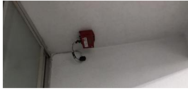
d. 頂樓強震儀配置照片
