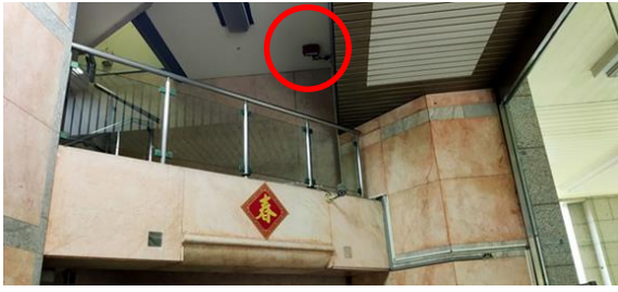
c. 2樓強震儀配置照片
