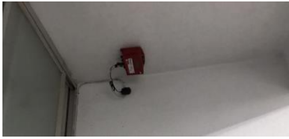
c. 2樓強震儀配置照片
